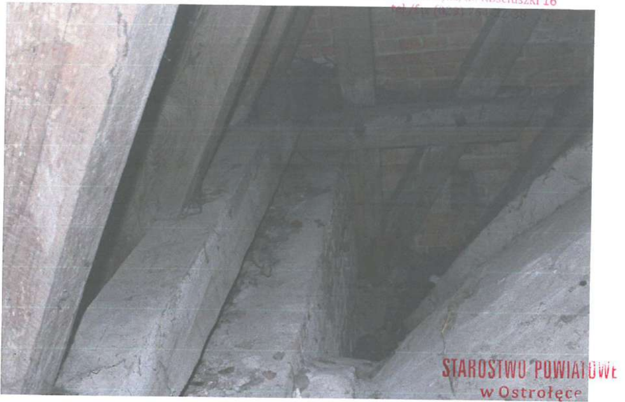
Zdjęcie nr 11 – słup i krzyżulec oczyścić z brudu i resztek – zabezpieczyć środkami p.poż. i grzybobójczymi, umożliwić przewietrzenie
