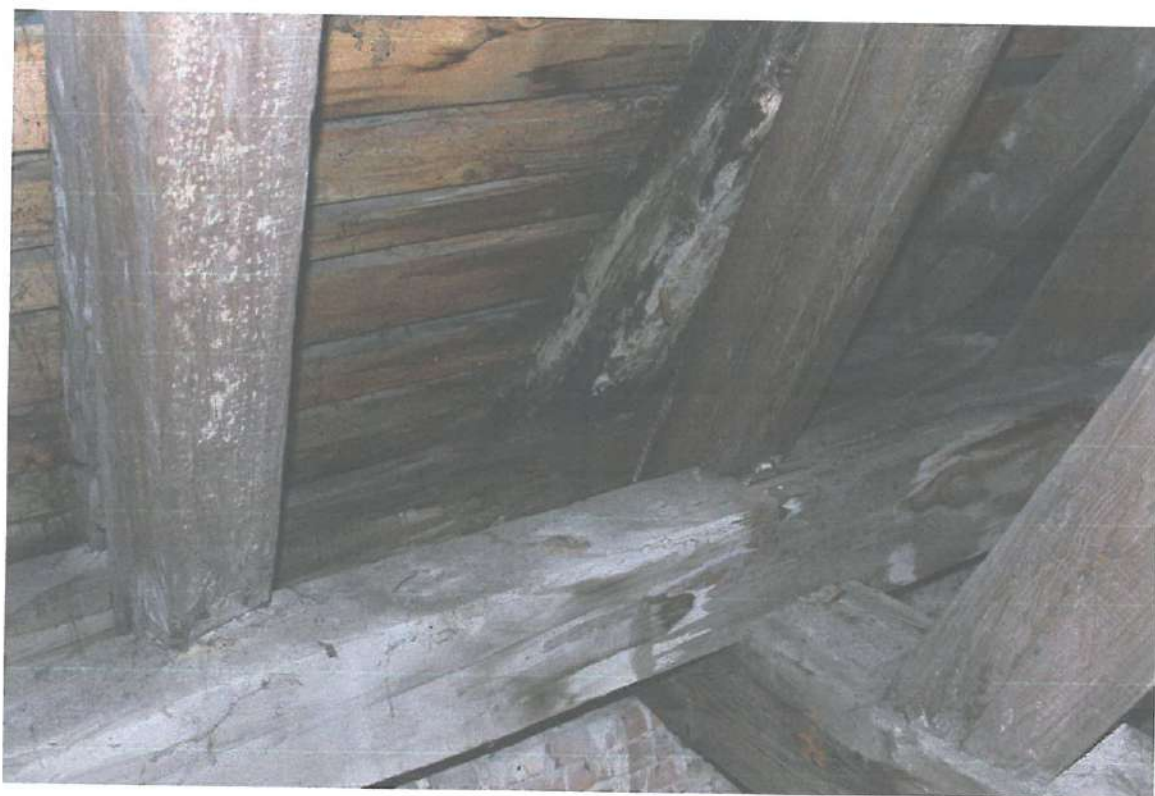
Zdjęcie nr 9 - nieszczelność pokrycia - zamknięta podwalina (belka wiązarowa), murlaty, krokiew i przypustnica. Przypustnicę należy wymienić. Po wymianie, osuszeniu, oczyszczeniu i impregnacji istniejącego drewna zalecane uszczelnienie pokrycia lub jego wymiana.
