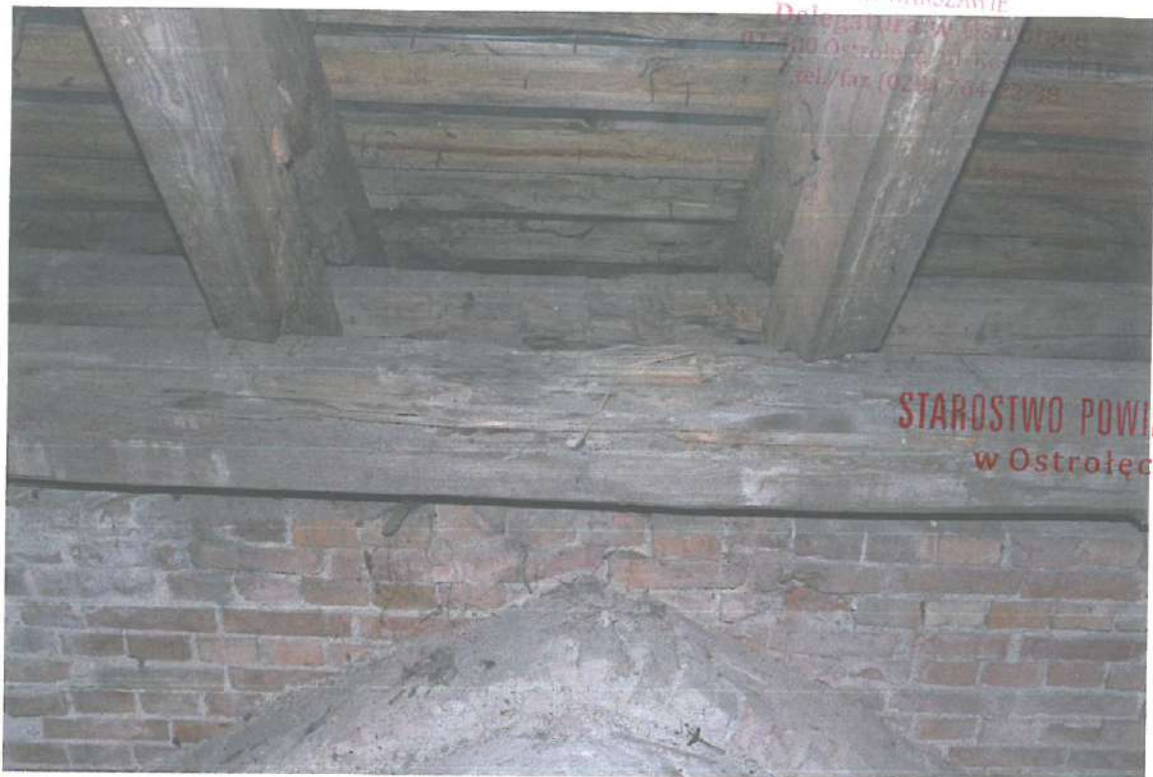
Zdjęcie nr 3 - mechaniczne uszkodzenia murłat (namurnic), krokwi i przypustnic należy pozostawić, impregnując i zabezpieczając powierzchniowe uszkodzenia bieli po ówczesnym ich oczyszczeniu.
