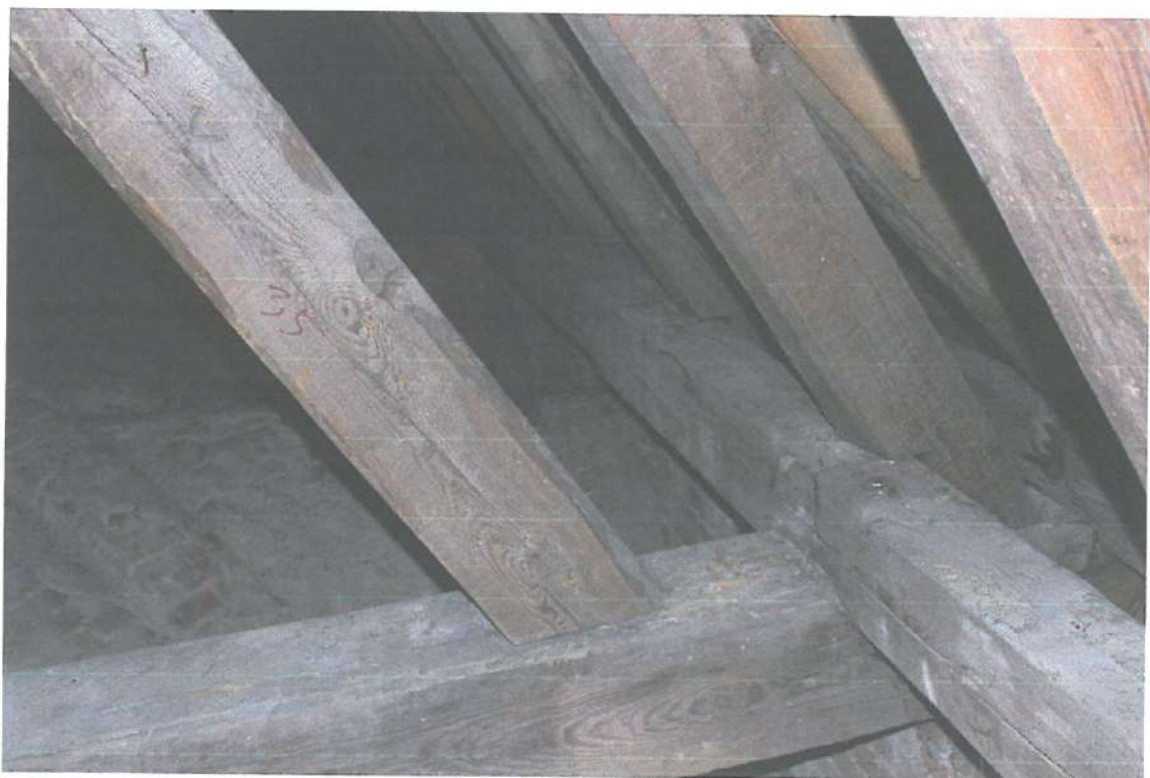
Zdjęcie nr 4 - mechaniczne uszkodzenia podwaliny (belki wiązarowej). Element należy pozostawić, impregnując i zabezpieczając powierzchniowe uszkodzenia bieli po ówczesnym jej oczyszczeniu.
