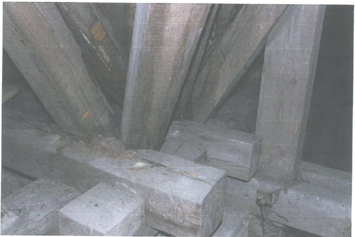
Zdjęcie nr 10a - degradacja w początkowej fazie – murlata wewnętrzna (namurnica) i przypustnica wymaga interwencji i zabezpieczenia środkami p.poż i grzybobójczymi
