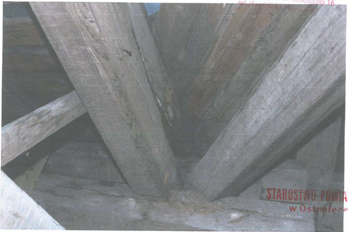
Zdjęcie nr 10 - degradacja w początkowej fazie – murlata wewnętrzna (namurnica) i przypustnica wymaga interwencji i zabezpieczenia środkami p.poż i grzybobójczymi
