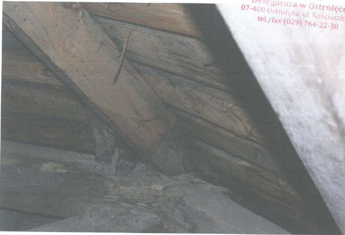
Zdjęcie nr 17 - widoczna próba naprawy poprzez nabicie nakładki. Nieszczelność dachu, końcówki belek wiązarowych wg autorów do wymiany. Po wymianie drewno zabezpieczyć środkami p.poż. i grzybobójczymi
