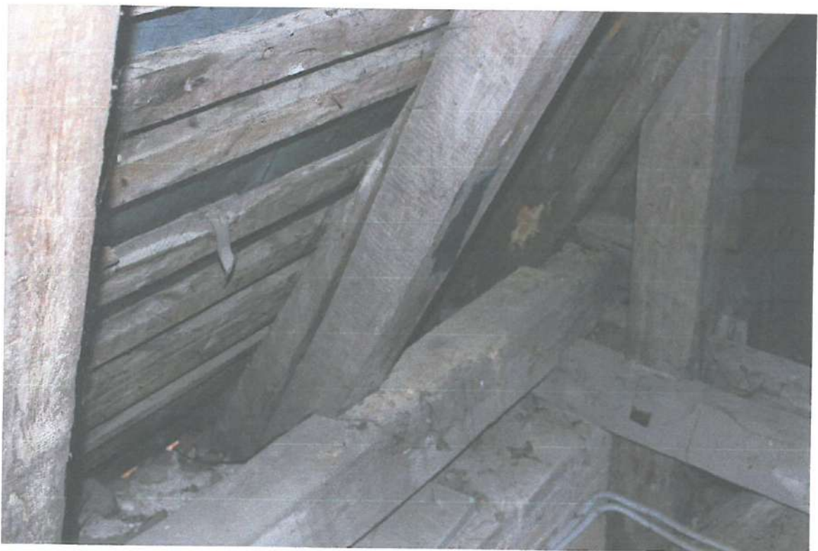
Zdjęcie nr 12 - uszkodzona warstwa bieli murłaty (namurnicy) - drobne uszkodzenia bieli usunąć. Pozostałą powierzchnię impregnować środkami przeciwgrzybicznymi i niepalnymi.
