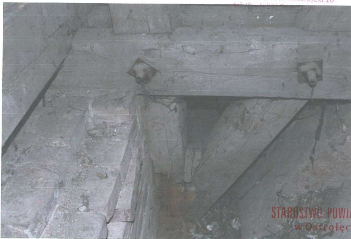
Zdjęcie nr 13 – słup i krzyżulec oczyścić z brudu i resztek, wymienić część zdegradowaną, – zabezpieczyć środkami p.poż. i grzybobójczymi, umożliwić przewietrzanie
