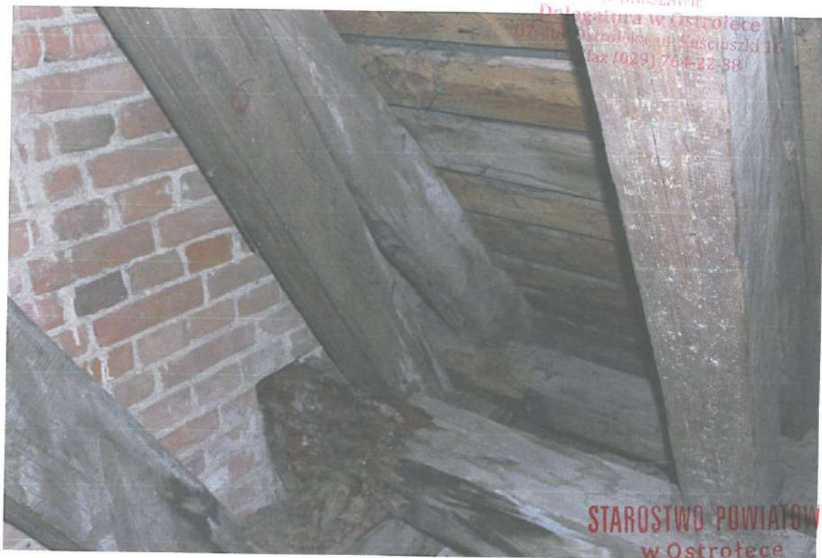
Zdjęcie nr 8 - długotrwały zaciek-zniszczone końcówki murlaty zewnętrznej i wewnętrznej (namurnic) i podwaliny (belki wiązarowej) - kwalifikują się do wymiany. Po wymianie drewno należy zaimpregnować – zgodnie z opisem.
