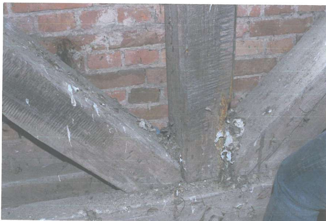
Zdjęcie nr 14 – słup oczyścić i zabezpieczyć środkami p.poż. i grzybobójczymi
